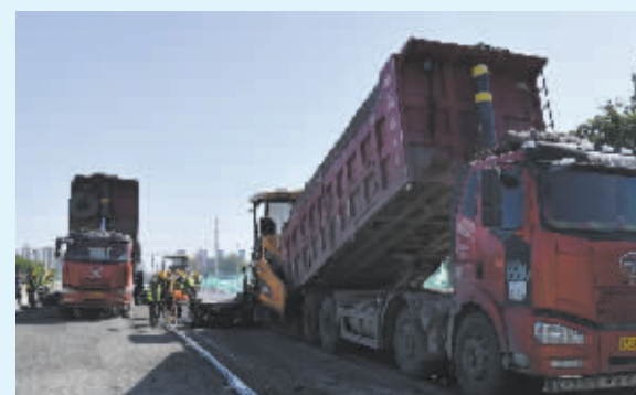
10月1日，在石家庄市仓盛路（建设大街至仓兴街）工程现场，施工人员坚守岗位，加紧进行路面的铺油施工，保证工程顺利完成。本报首席记者 张震 摄
