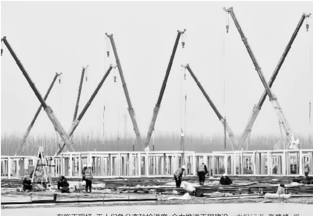
在施工现场,工人们争分夺秒抢进度,全力推进工程建设。本报记者 张晓峰 摄
