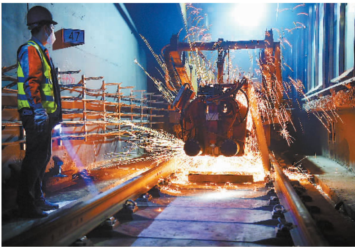
8月12日,随着地铁3号线市庄站附近最后一段轨排的焊接完成,3号线一期北段工程(西三庄站—市二站)实现“轨通”。图为地铁技术人员正在进行施工作业。 本报记者 张晚峰 摄
